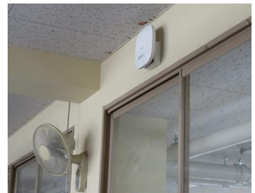
教室に設置した無線ルーター
